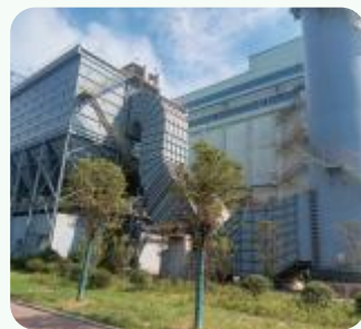
高爐礦槽布袋除塵系統
