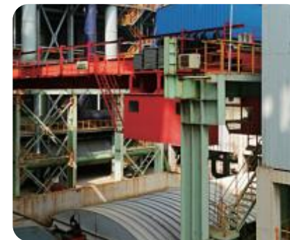
高炉冲渣水处理系统
