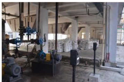
改善后图片（化产分厂脱硫工段）：生产现场干净、明亮，各设备、控制箱标识清楚，产品摆放整齐
