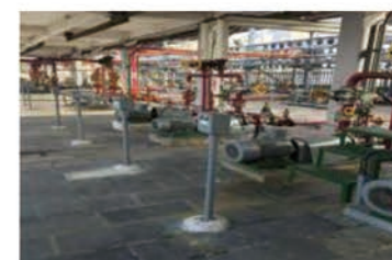
改善后图片（化产分厂油库工段）：现场地面、设备卫生较整洁，阀门、仪表盘等标识明确
