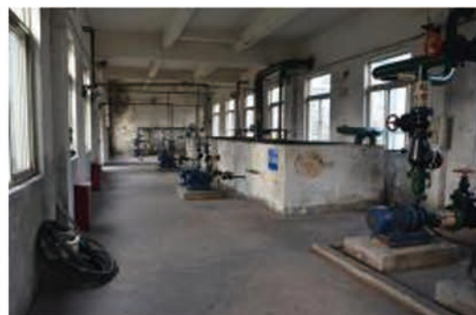
改善后图片（化产分厂生化工段）：泵房内通道畅通、物品、设备标识清楚，现场环境较干净明亮
