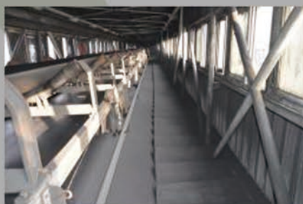
改善后图片（储运公司焦C103皮带线）：皮带通廊无焦粉堆积，皮带支架清扫较干净
