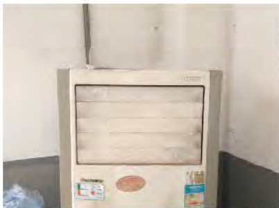
▲问题图片（炼焦分厂捣固调火排班室）：空调表面积灰未清理，导致积灰较重。处罚100元
