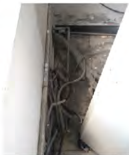
▲问题图片（储运公司中控室）：空调后地面卫生未清理，此处属于盲区。处罚100元
