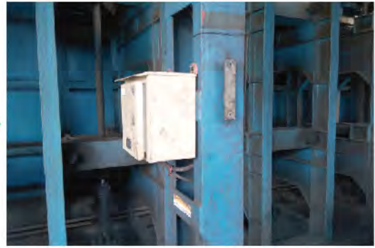
▲整改后图片（炼焦分厂捣固2#装煤车）：完成整改
