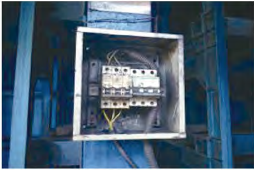
▲问题图片（炼焦分厂捣固2#装煤车）：控制开关裸露在外，无防护措施。处罚100元
