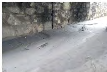
▲问题图片（储运公司焦309皮带下方）：焦粉堆积在现场未清理，造成地面粉尘较重及现场环境差。处罚100元
