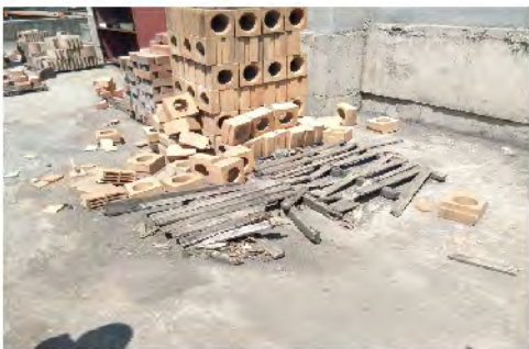
▲问题图片（炼焦分厂捣固熄焦塔处）：现场废弃木板未处理，工完料未清。处罚100元
