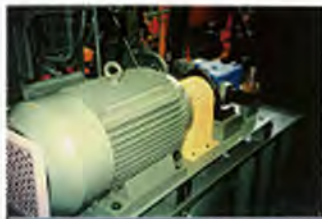
马达清洁干净且装有空气滤芯
