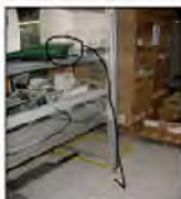
零件易脱落，需要维修
